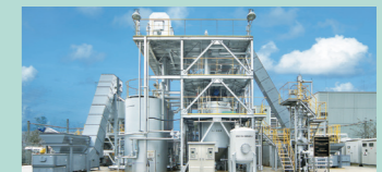
バイオエタノール製造実証設備 (京都市京都市)
