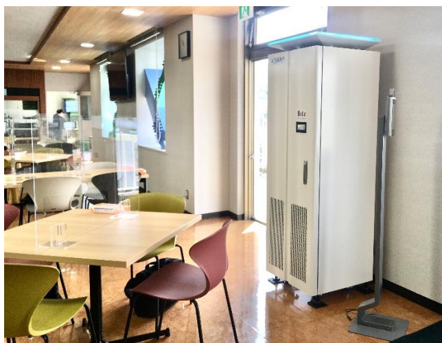
【九州電力の発電所内食堂に設置】
