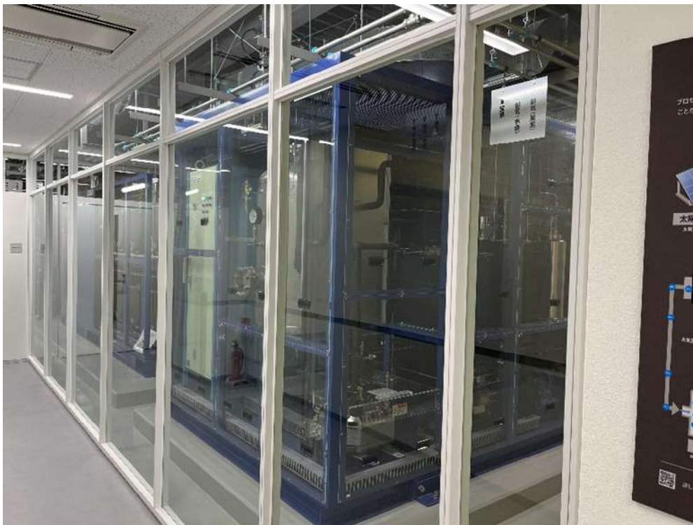
【水素発生装置が組み込まれた設備】
