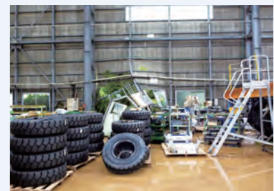
工場建屋壁面の損壊と浸水
