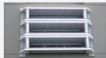
壁面設置型フラップゲート式水害対策設備
