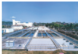
● 上下水処理プラント
