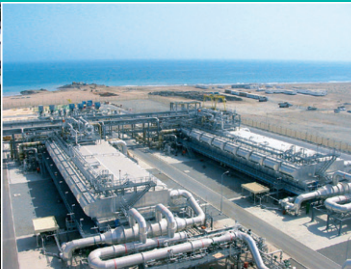
海水淡水化プラント
