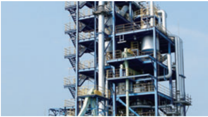
福岡バイオ水素プロジェクト大牟田プラント
