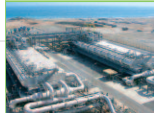
海水淡水化プラント
