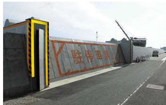
陸上設置型フラップゲート式可動防潮堤 neo RiSe® 徳島県(豊益地区)
