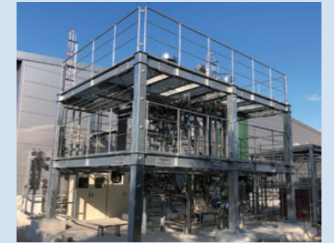
PtG Squareのメタネーション設備
