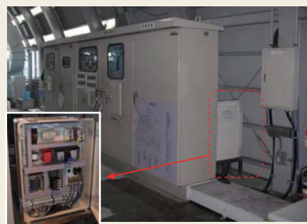
図11 データ収集装置の設置状況
