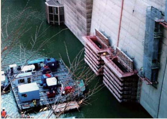
図17 五十里ダム仮締切設備
