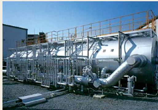
図23 メタン発酵設備
