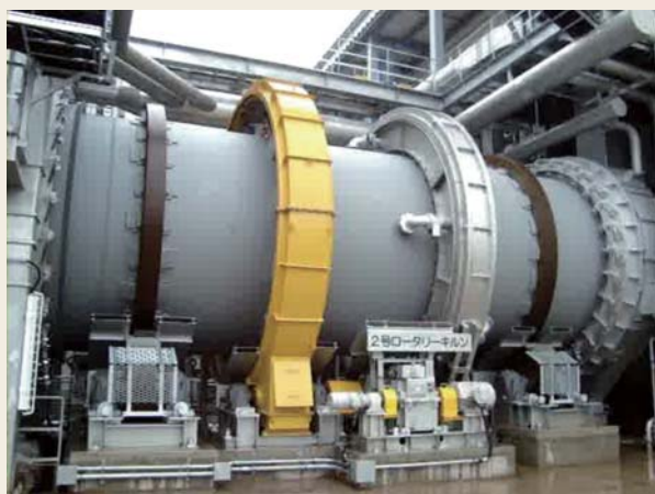
図12 中間空気吹込み式キルン
