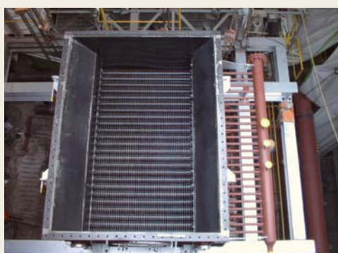
図20 フィン付管型エコノマイザ設置状況 (コンパクト化)
