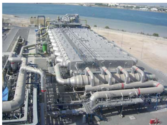
ウム・アル・ナルMSF造水プラント(UAE, アブダビ)
