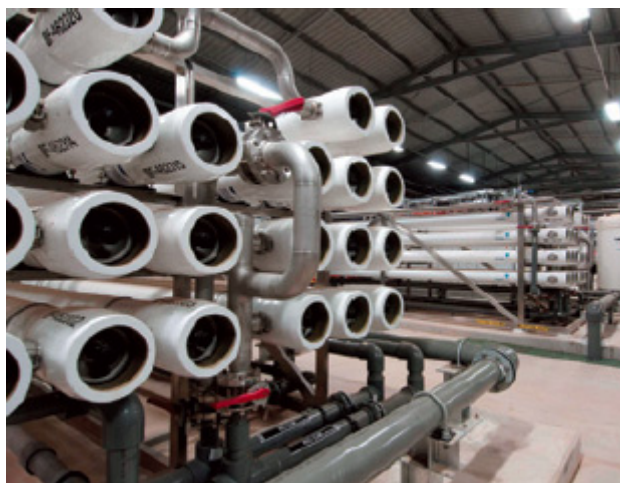
Reverse osmosis membranes (RO membranes)
