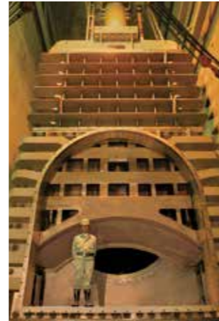
ジェットフローゲート Jet flow gate
