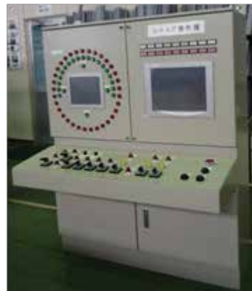
シールド掘進機 操作盤 Shield Tunneling Machine Operation Panel
