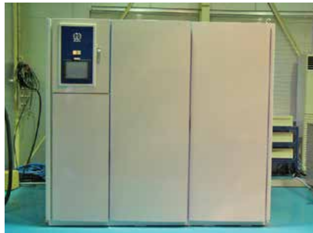
超純水製造装置 Ultra Pure Water System
