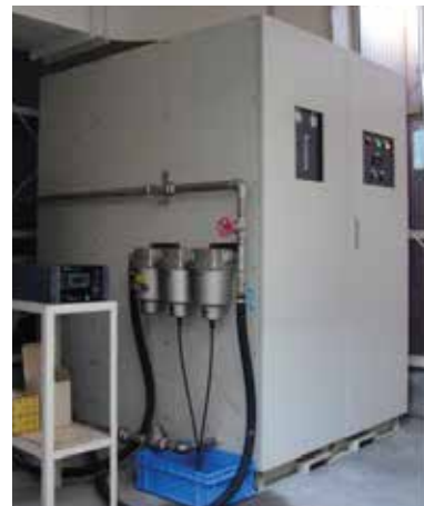
窒素ガス発生装置 Nitrogen Generator
