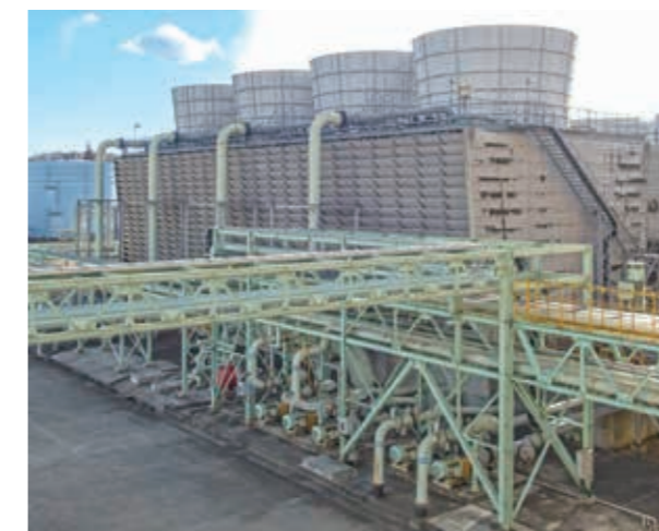
冷却塔設備(3号機) Cooling tower (Unit 3)
