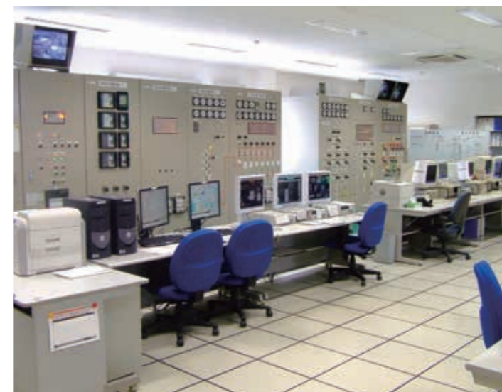
中央操作室 Central control and operation room
