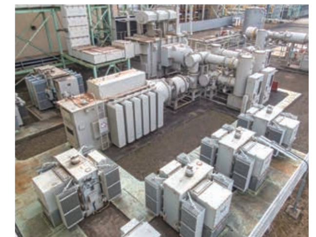
受変電設備(3号機) Substation (Unit 3)
