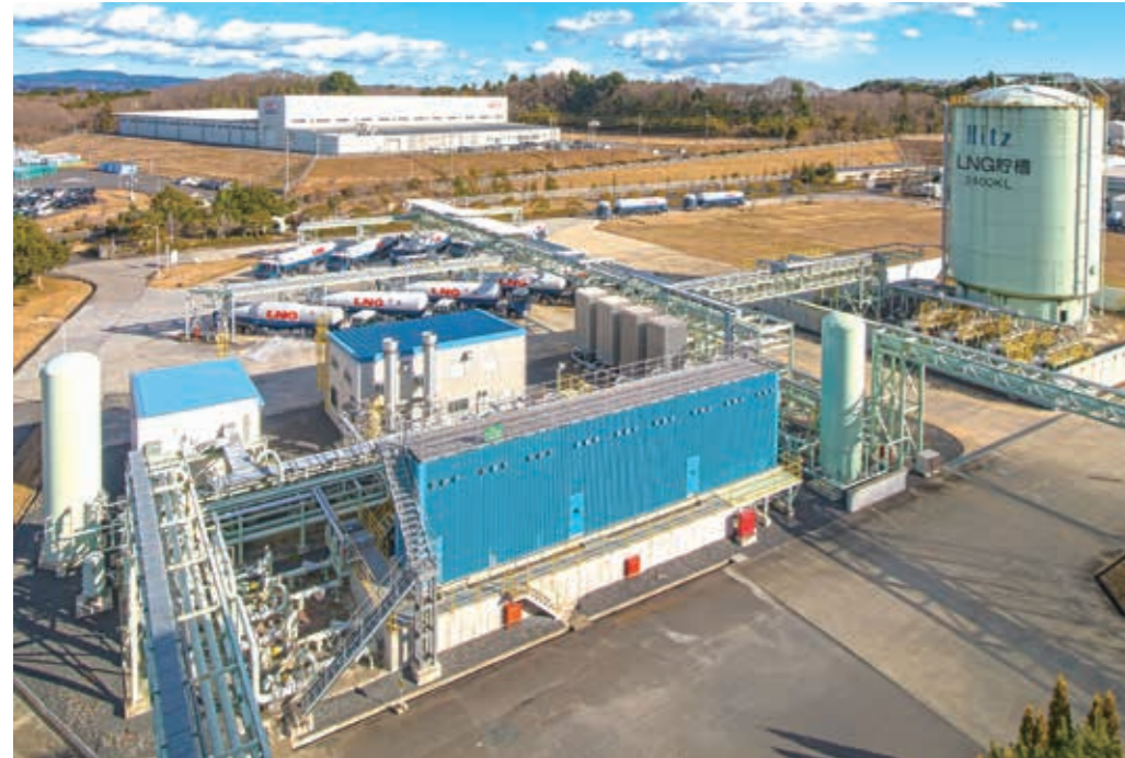
LNGサテライト全景 Overview of LNG Satellite Station
