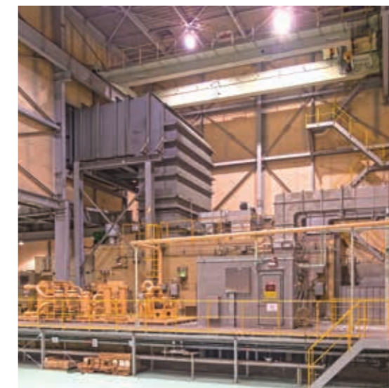
ガスタービン設備(2号機) Gas turbine (Unit 2)
