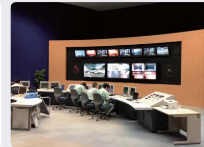
●AOM (アフターサービス、運転管理、薬剤販売) / 運営事業 臨海工場中央制御室 焼却施設、リサイクル施設を合わせ140施設以上のアフターサービス業務と50件以上の運転委託業務、30件以上の包括運営委託を請け負っています。
