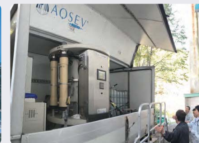
トラック搭載型AQSEV® (AMF-1805D)のデモ機
