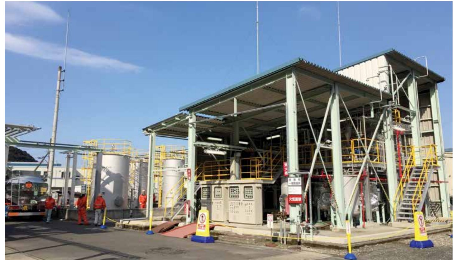
トチュウエラストマー® 精製装置 Eucommia Elastomer Purification Equipment
