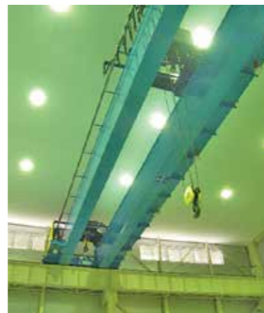
天井クレーン Overhead Traveling Crane
