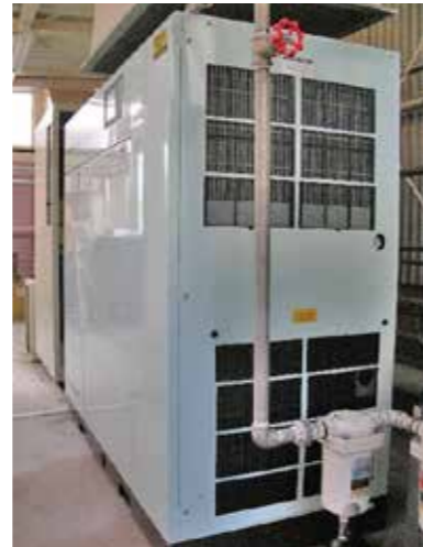
エアコンプレッサ Air Compressor
