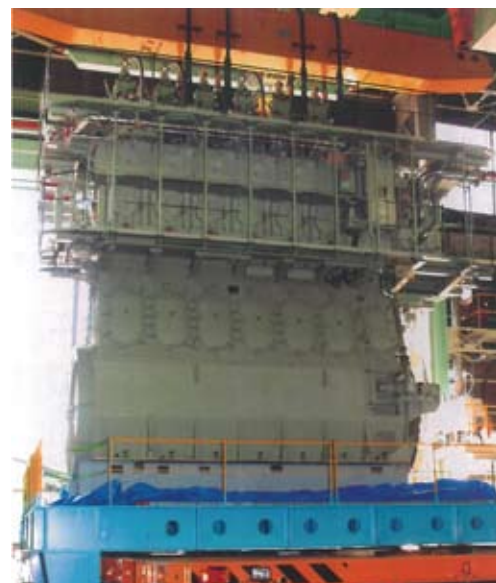
ディーゼルエンジン 一体搬出設備 Equipment for taking out diesel engine units
