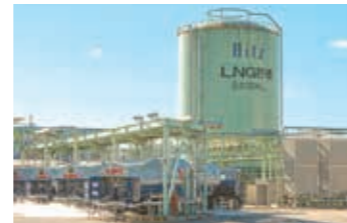
LNG貯槽とローリーステーション LNG storage tank and receiving station
